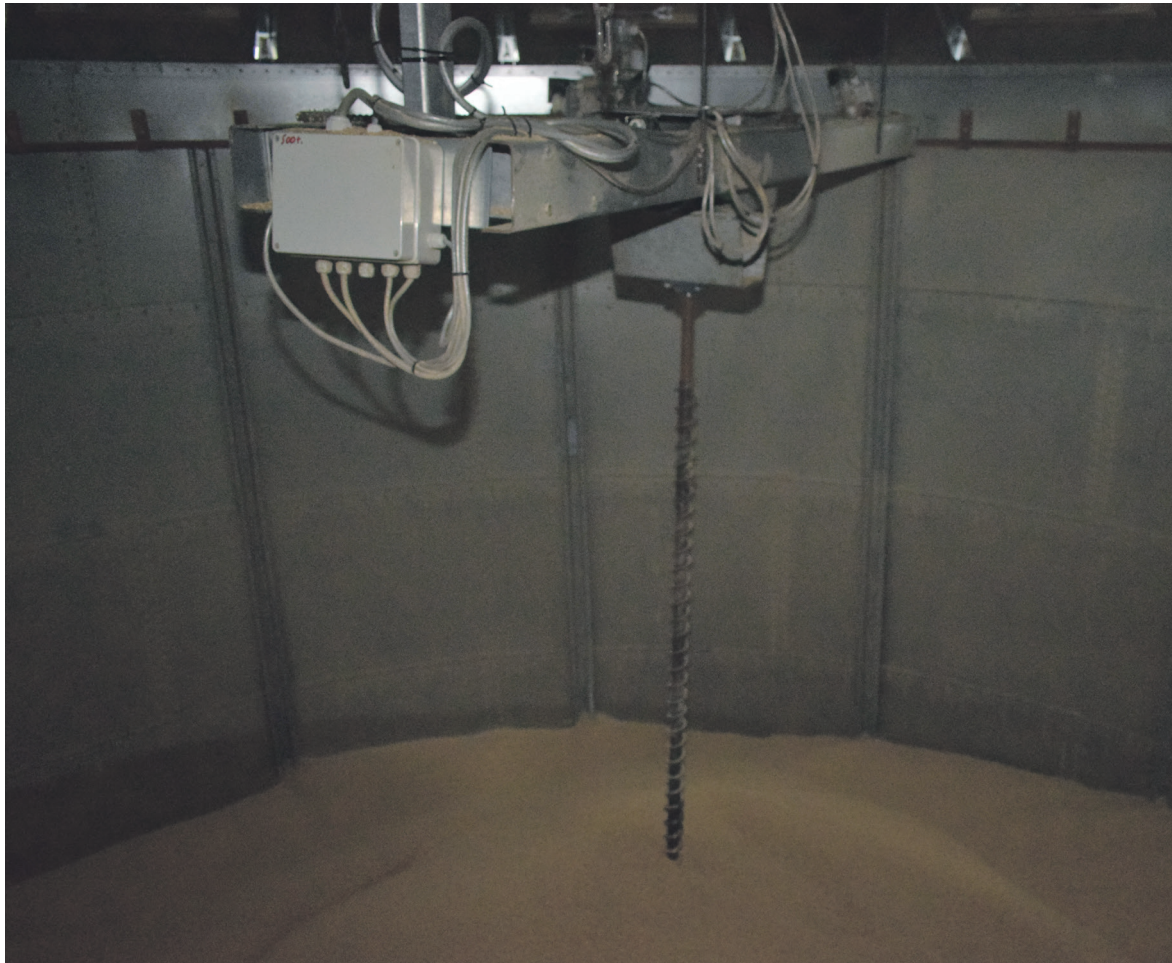
In een buitensilo met roerinstallatie is het mogelijk nat graan gecontroleerd terug te drogen naar 15% en voor lange tijd te bewaren. Het roersysteem in een graansilo bestaat uit één of meerdere verticale vizels aan een roer-arm. Deze arm hangt bovenin de silo en rijdt over een rail, die aan de wand gemonteerd is.
